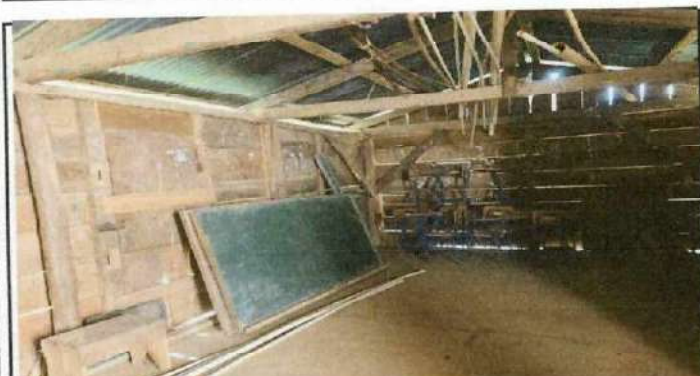
Foto 3: el piso del aula se encuentra desgastada, necesita sustitución.
