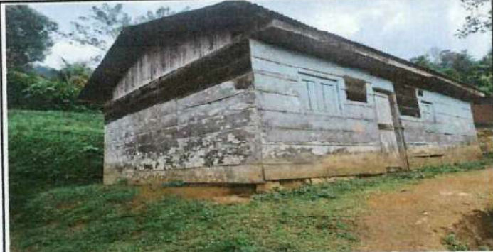
Foto 2: la puerta y las ventanas se encuentran en condiciones inadecuadas.
